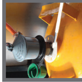
Connexion du détendeur à la bouteille de gaz
